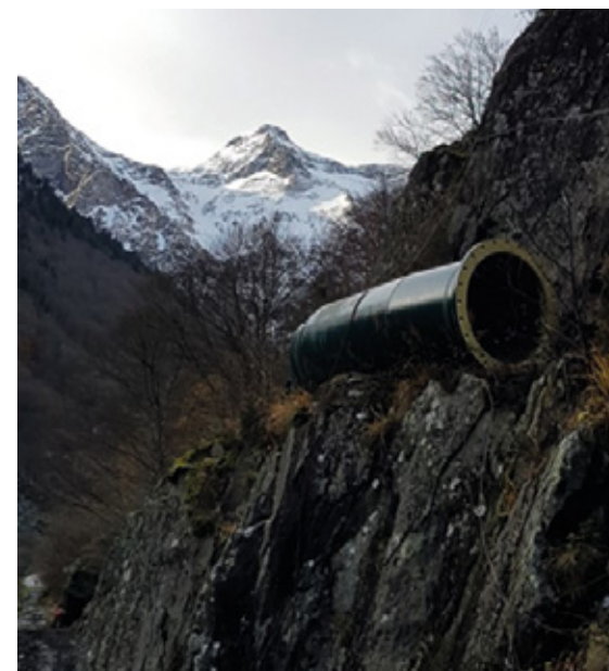
Conduite forcée DN 800
