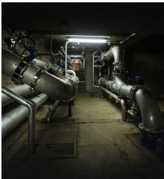
Tuyauterie Réfrigération DN300 Filtration en ligne sous 8 bars
