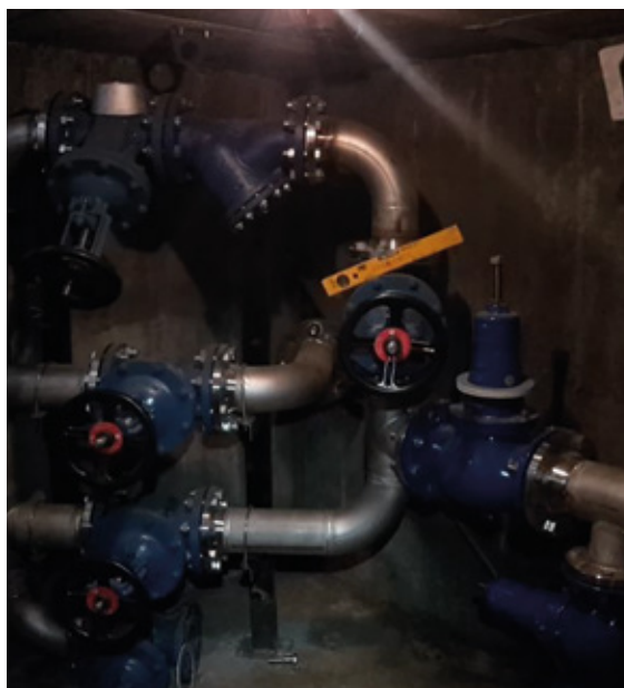
By Pass détente et filtration 35 bars
