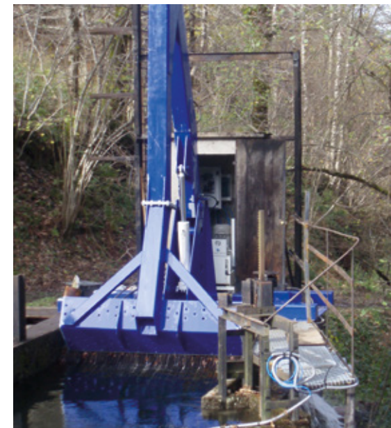
Dégrilleur hydraulique type Pelle
